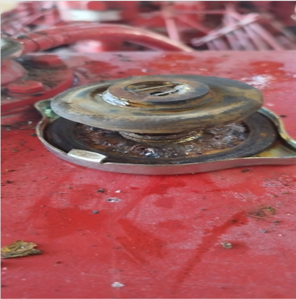
Reemplazar tapa de depósito de refrigerante
