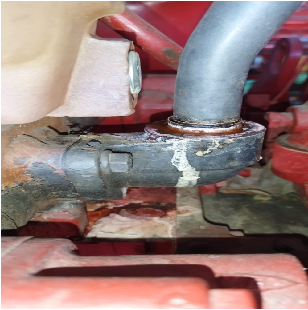
Fuga de refrigerante
