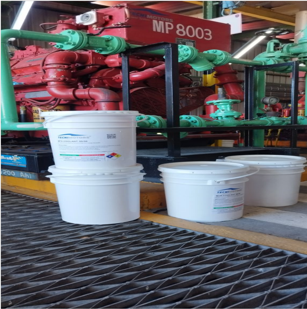
Líquido refrigerante nuevo
