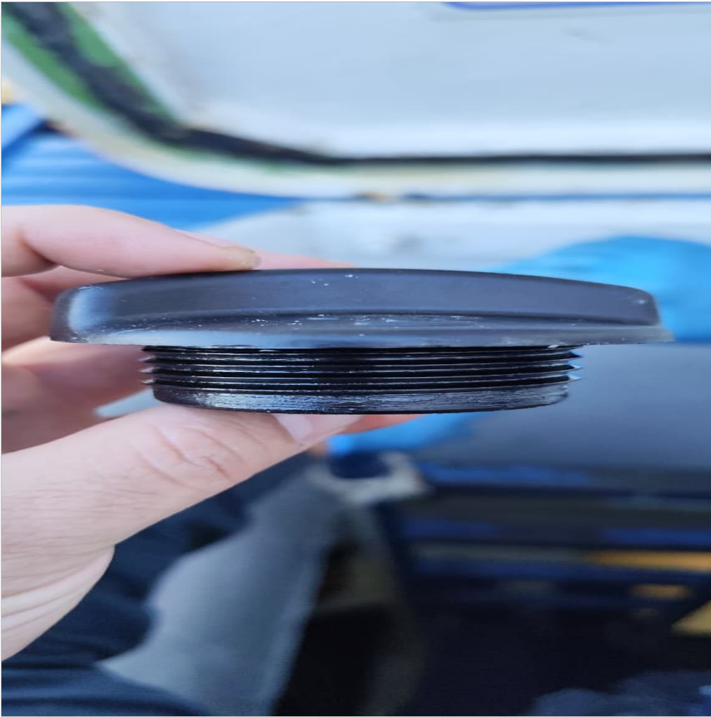
tapa de tanque compensador dañado
