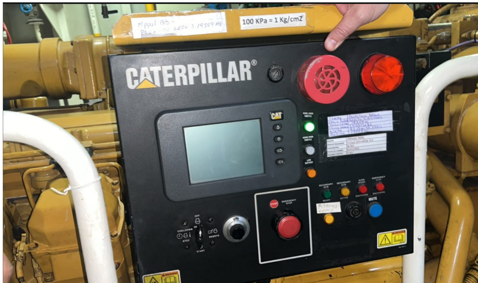
Selectora Nueva Instalada MPD
