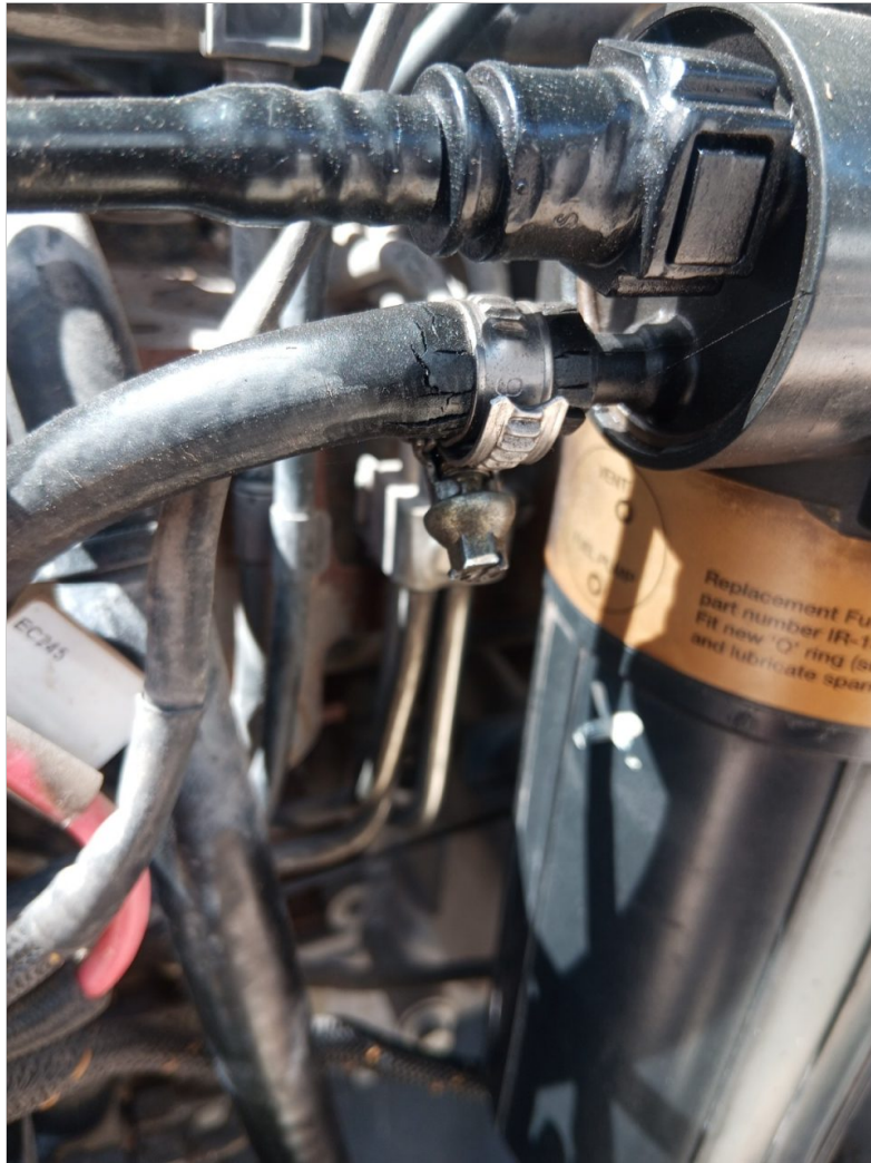
manguera dañada de combustible
