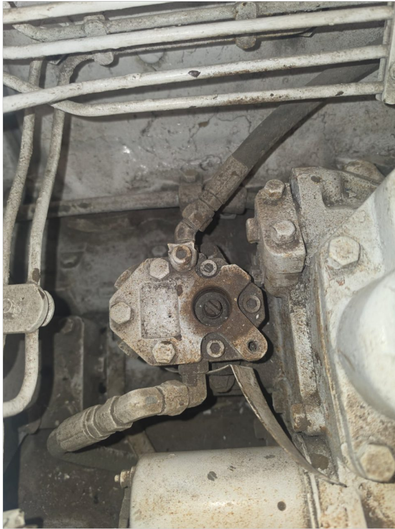
alojamiento de odometro en bomba de transferencia
