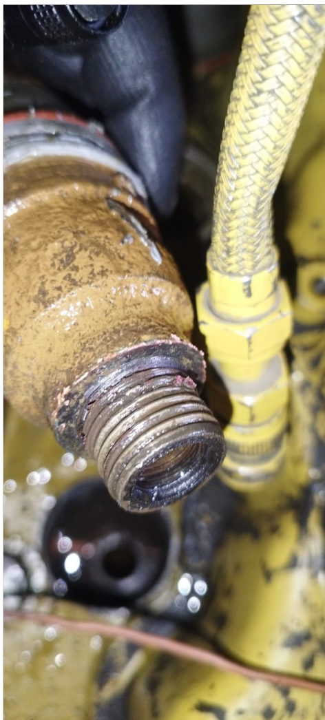
Estado de precamaras al momento de desmontarlas
