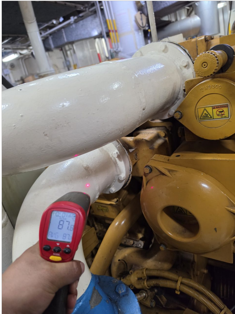
Control de temperatura
