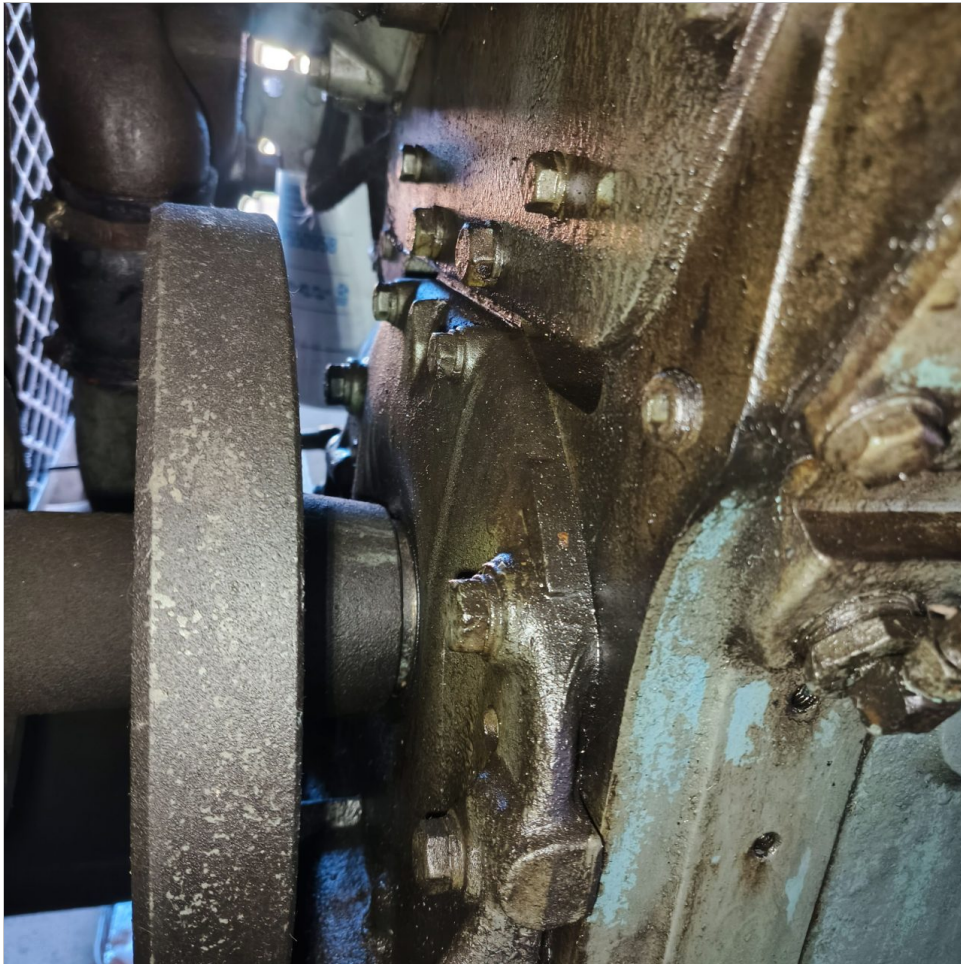
Observacion de perdida de aceite
