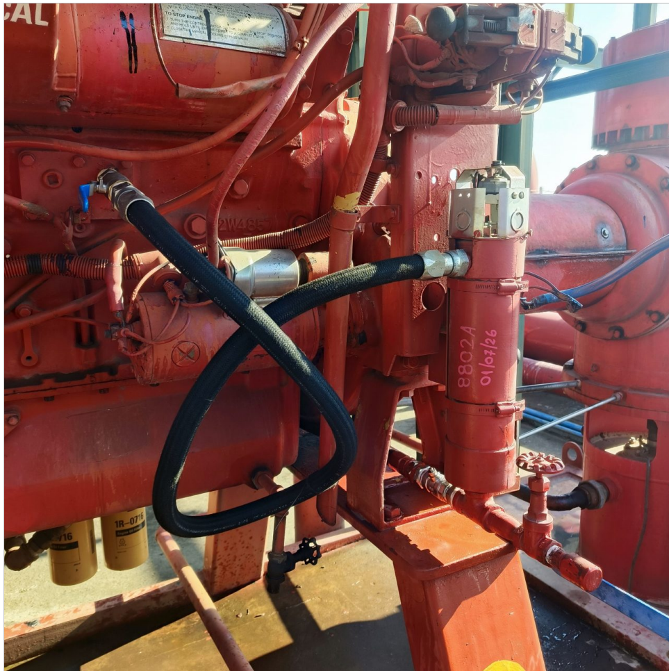
Calentador instalado y grifos en entrada y salida del circuito
