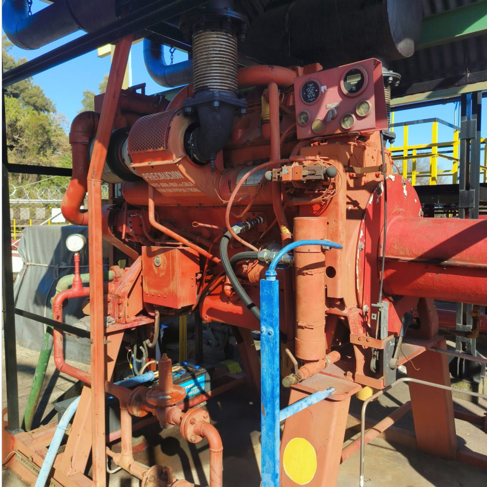
Revision de cicuitos lado arranque electrico
