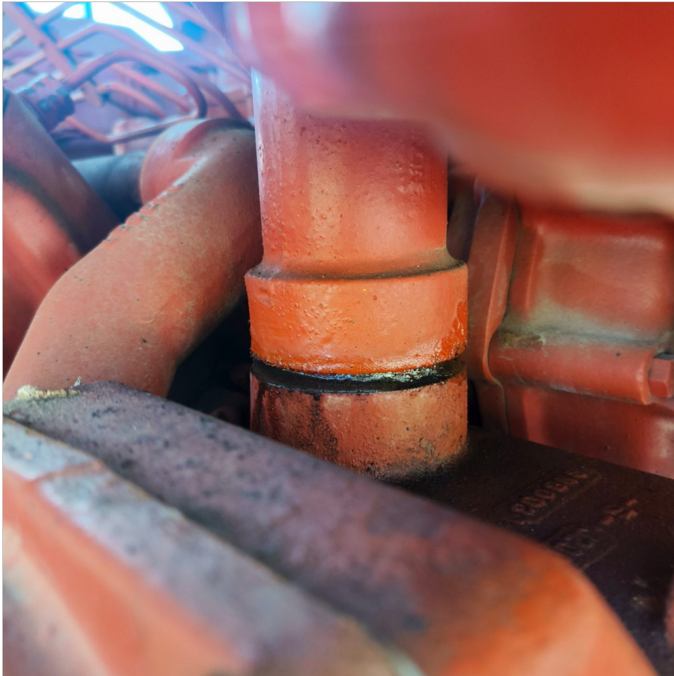
Observacion de perdida en codo
