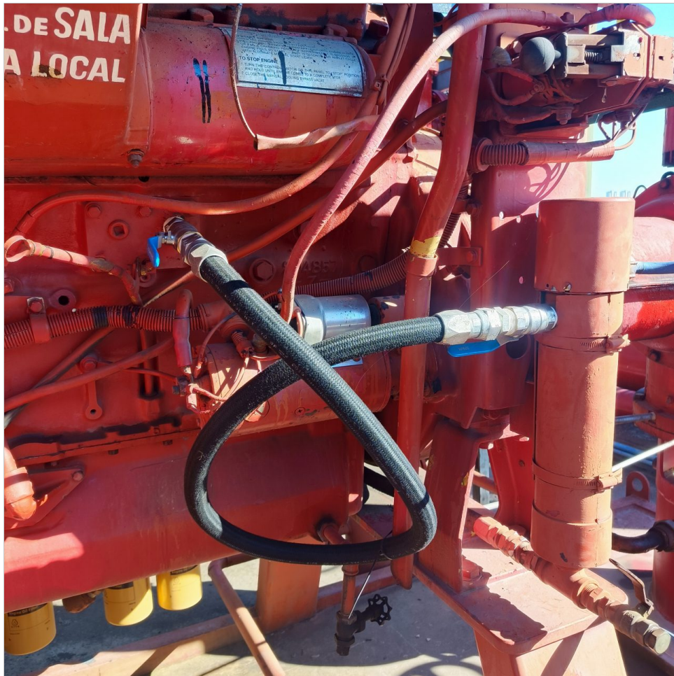
Línea de calentamiento
