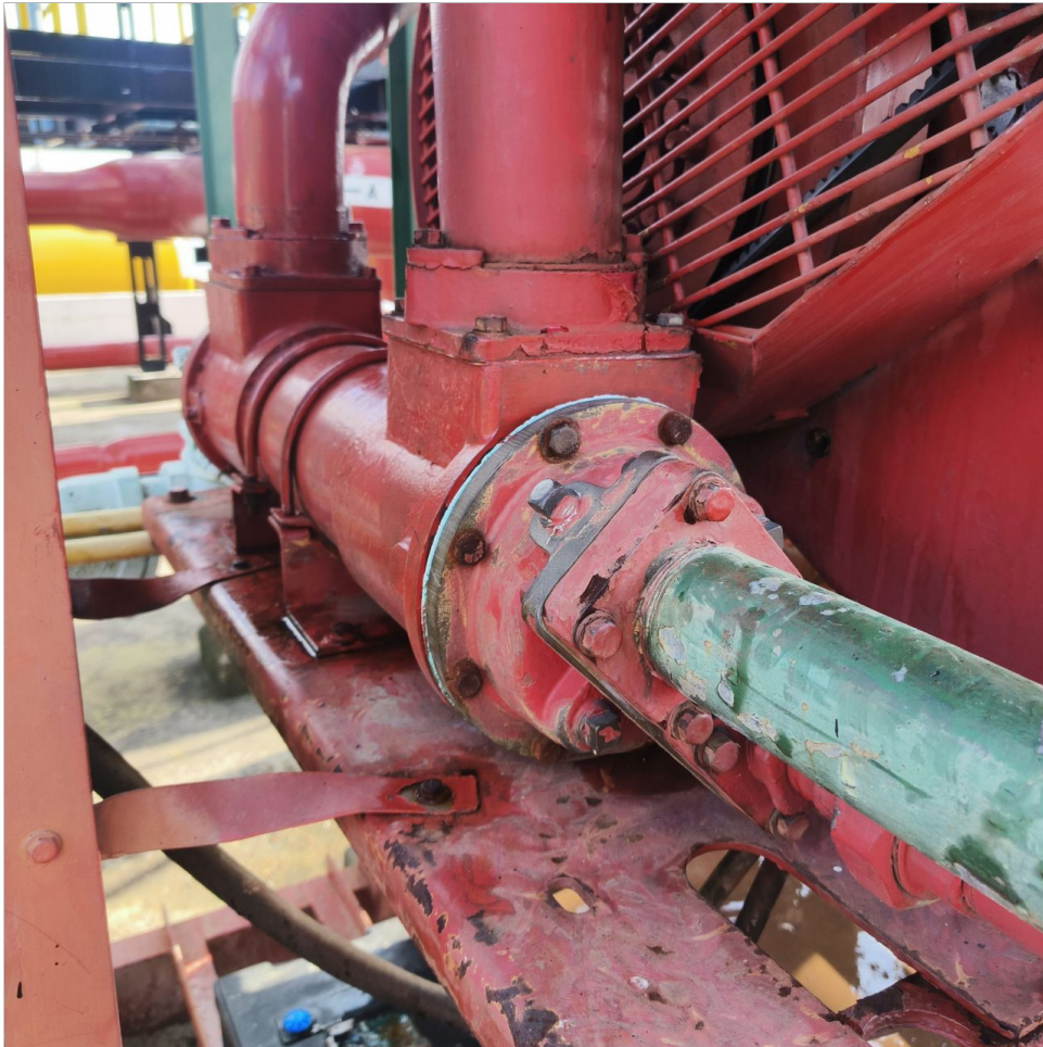
Intercambiador de calor observado por contaminacion de circuito
