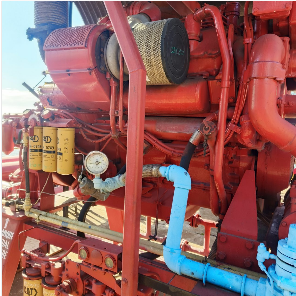
Reivision circuitos lado filtros
