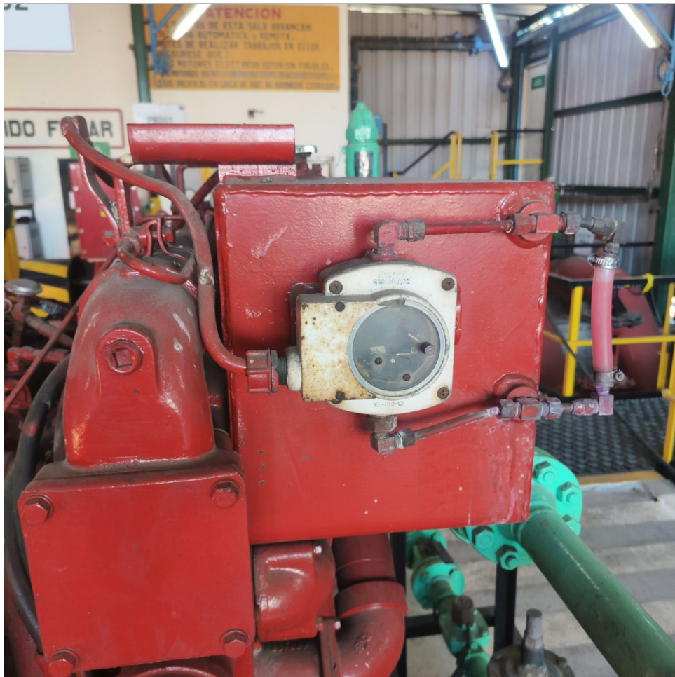
Deteccion de goteo en visor del tanque de expansion
