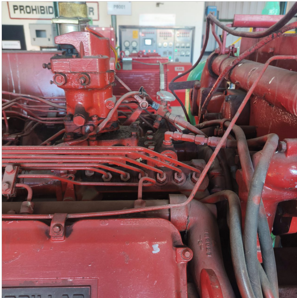
Tuberías de combustible
