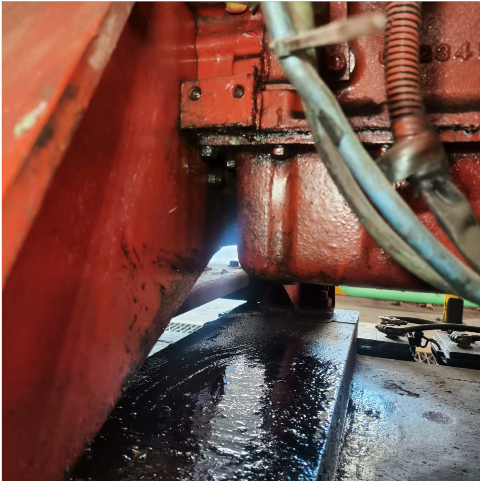
Deteccion de perdida de aceite
