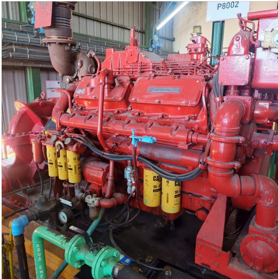
Revision de circuitos lado filtros
