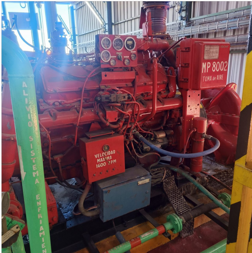
Revision de circuitos lado arranque
