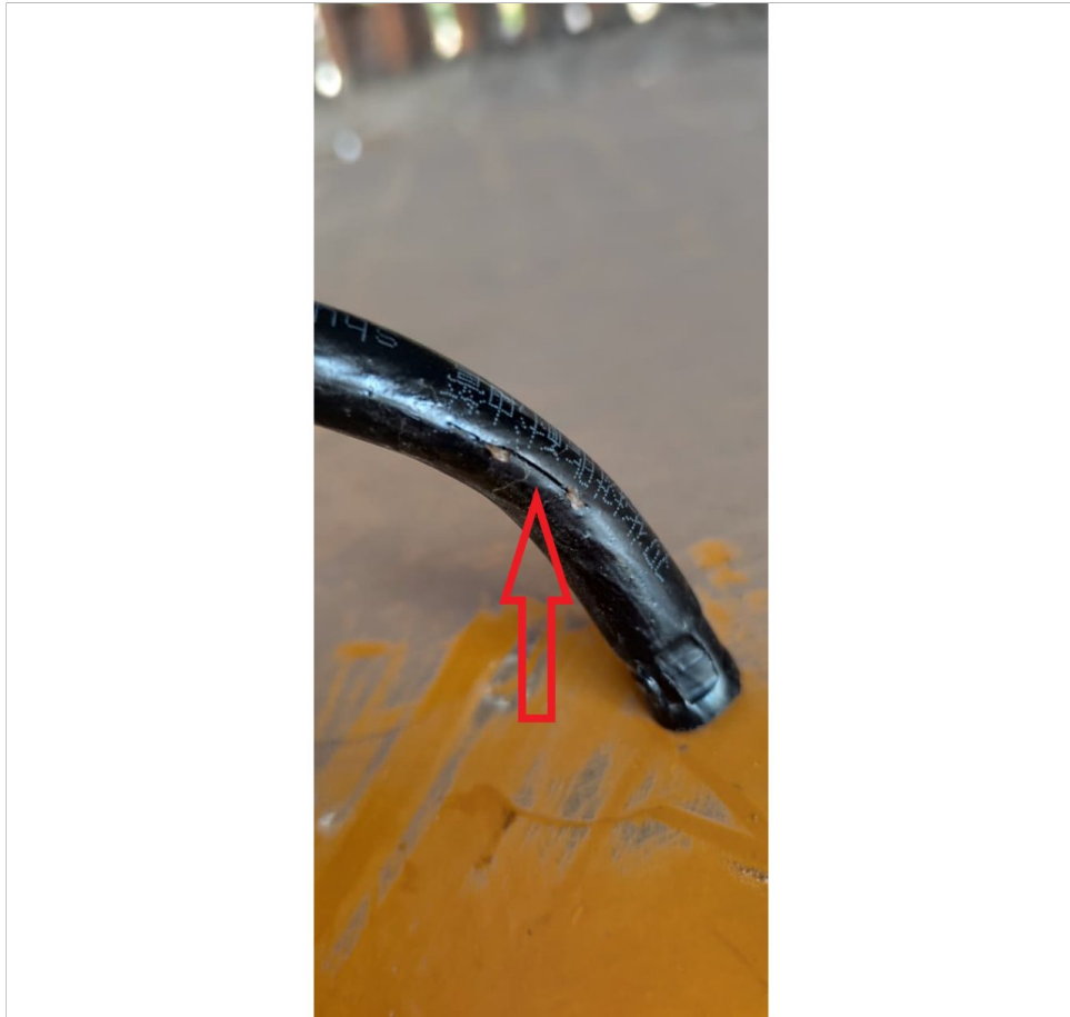
MANGUERA DETERIORADA DE GASOIL
