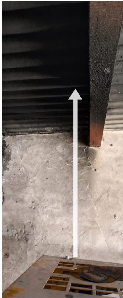
SALIDA DE ESCAPE HACIA LA PARTE SUPERIOR DEL RECINTO
