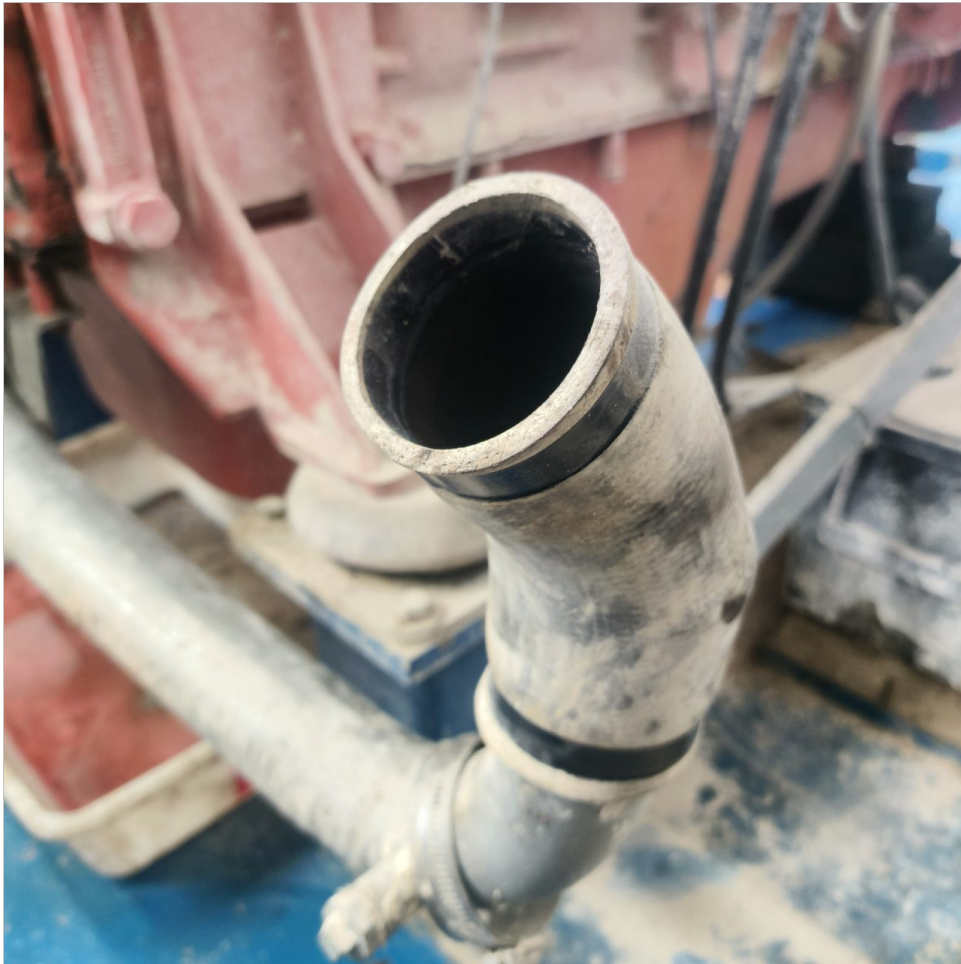
Mangueras y caños 2
