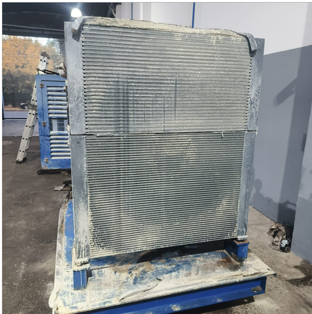
Radiador -Estado inicial
