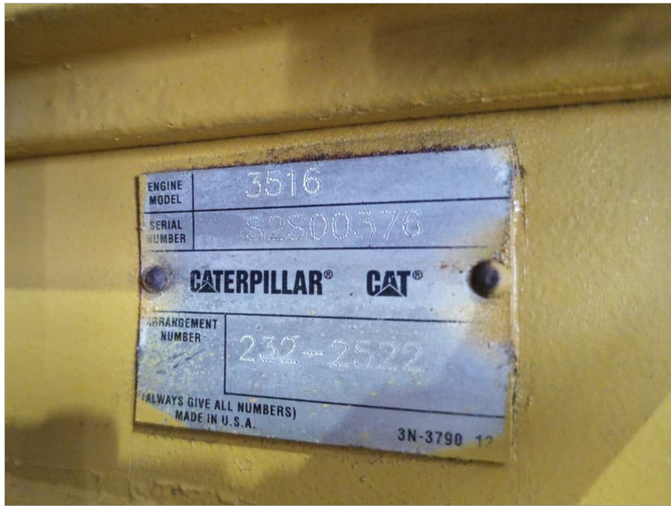
Motor Principal Cat 3516 Estribor. - Placa identificatoria.
