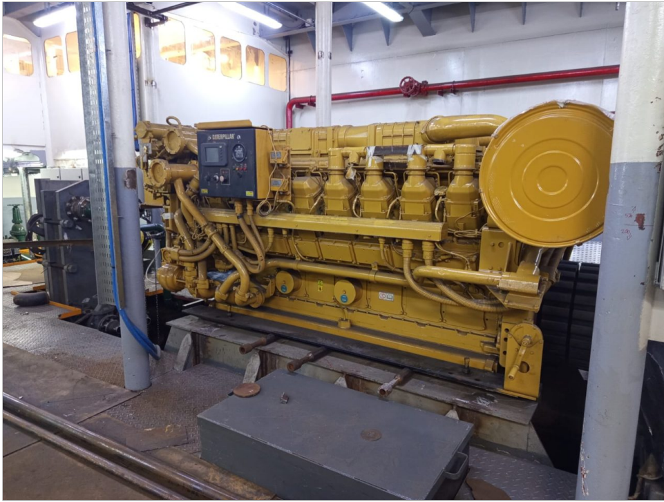
Motor Principal Cat 3516 Estribor. - Preparación de maniobra para alineación.
