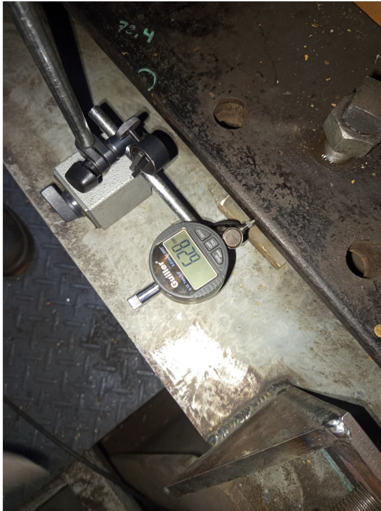
Motor Principal Cat 3516 Estribor. - Control de alineación.
