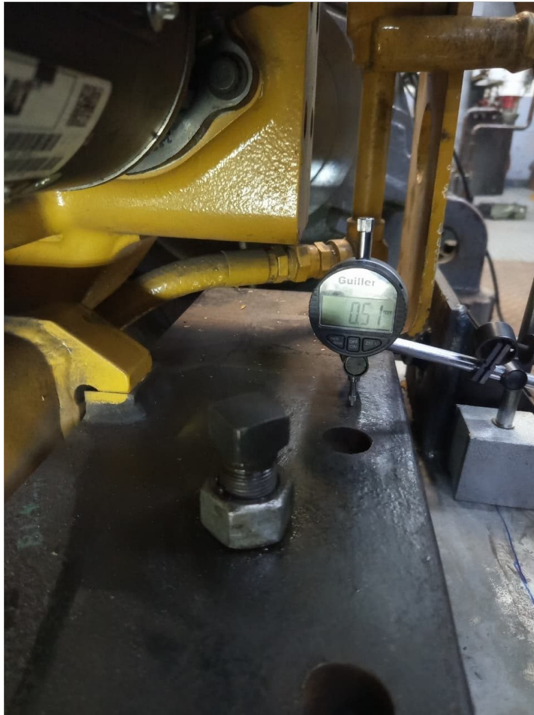
Motor Principal Cat 3516 Estribor. - Control de alineación.
