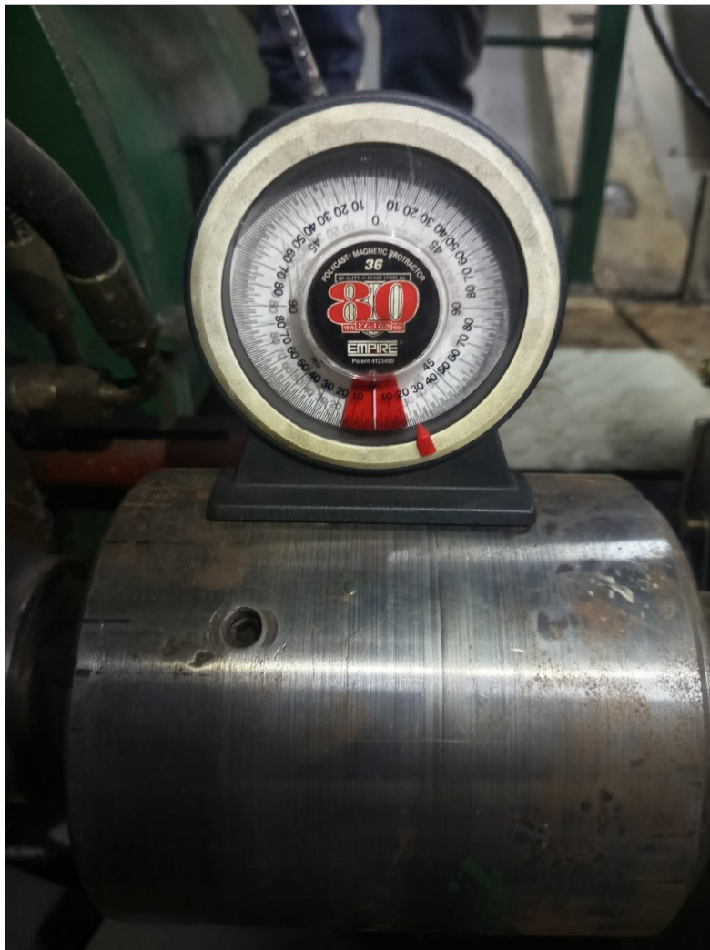
Control de alineación de línea de eje.
